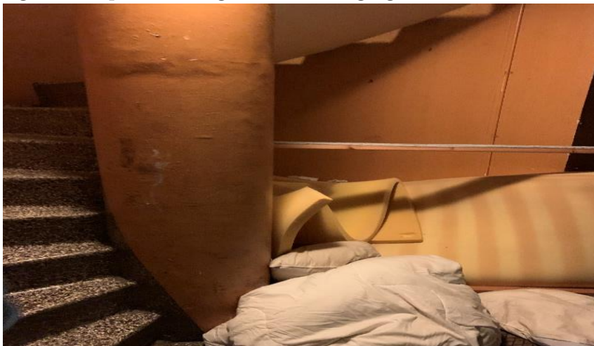
Figur 7: Dumpat brandfarligt material, källargångar
