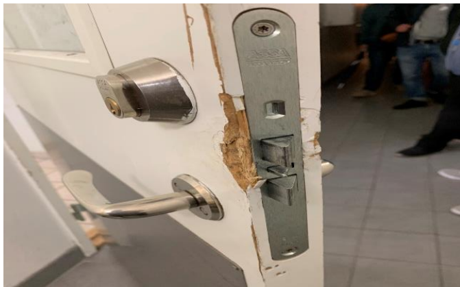
Figur 5: Skadegörelse, Tvättstugan, Bildalsgatan
